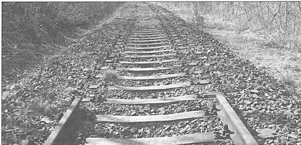
Zwischen Lüdershagen und Klein Grabow fehlen an die 40 Meter Gleise.
